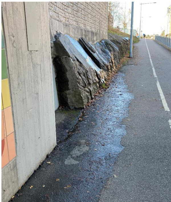
Figur 36. Vatten på gång- och cykelbanan i anslutning till bergskärning vid järnvägsporten vid Skrällebergsvägen.
